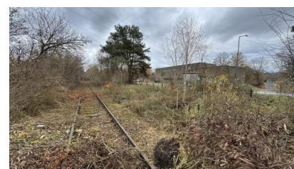
Am 20. November 2025 begannen wir mit den Vegetationsarbeiten zwischen Homburg (Saar) und Einöd (Saar) (November 2025) [Quelle: DB InfraGO AG]
