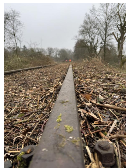
Bei Schwarzenbach führen wir Vegetationsarbeiten durch. Noch bis Samstag, 28. Februar 2026, können wir diese Arbeiten nach dem Bundesnaturschutzgesetz umsetzen (Januar 2026) [Quelle: DB InfraGO AG]
