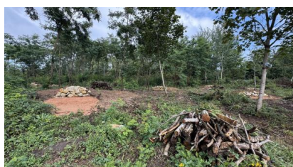
Fertigstellung der Interimsfläche für Eidechsen auf der Fläche im Gleisdreieck an der Saarbrücker Straße in Homburg (Juli 2025) [Quelle: DB InfraGO AG]
