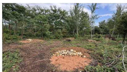
Fertigstellung der Interimsfläche für Eidechsen auf der Fläche im Gleisdreieck an der Saarbrücker Straße in Homburg (Juli 2025) [Quelle: DB InfraGO AG]
